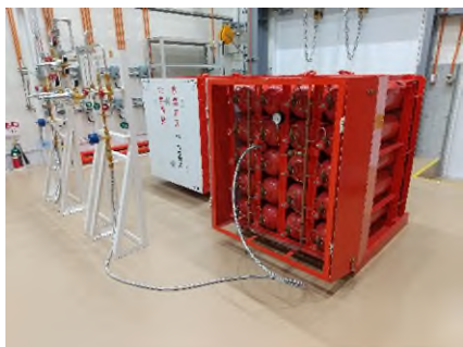
水素供給設備
