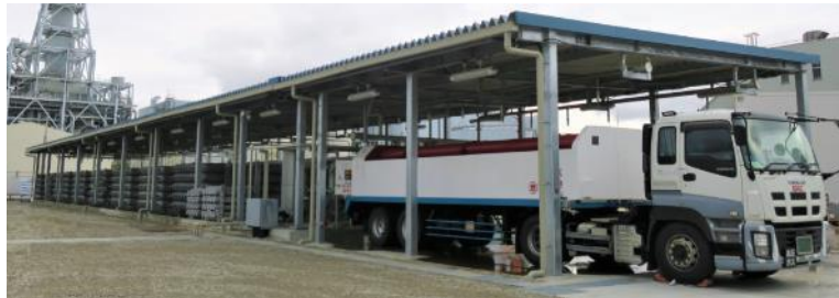
大容量水素供給設備
